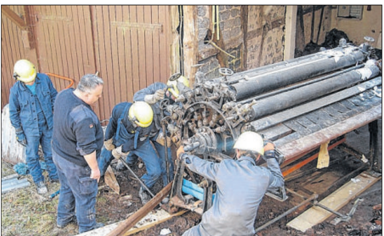
Körperliche Schwerarbeit beim zentimetergenauen Ausrichten des Eisenkolosses. THW-Technikchef Dirk Arnold gibt die Direktiven für die richtigen Hebelkräfte.
