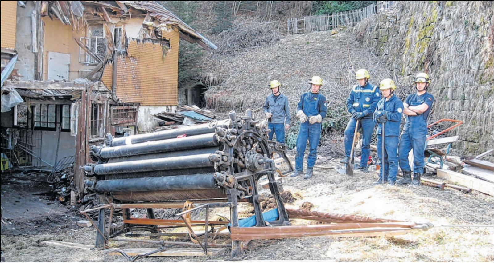
Die alte Wäschemangel des Hotel Waldlust hat dank des THW Freudenstadt den Weg ins Freie, aus dem teilzerstörten Gesindehaus heraus, geschafft. Bilder: sis
